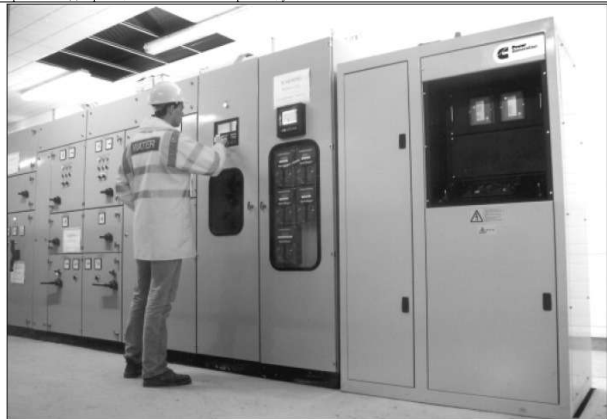
Шкаф цифрового главного контроллера (DMC), установленный рядом с распределительной аппаратурой водных компаний. Доступ осуществляется спереди.
