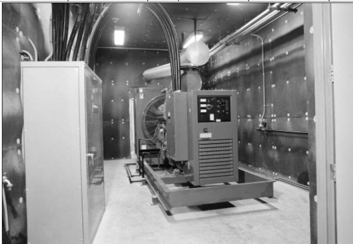
Клеммная коробка на панели управления для подачи питания на напольный автоматический шкаф генераторного агрегата на 625 кВА.
