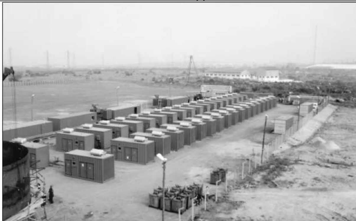
Тридцать девять агрегатов по 1125 кВА с двигателями KTA50 работают параллельно с использованием систем управления PCC и DMC, вырабатывая в совокупности 30 МВт энергии.
