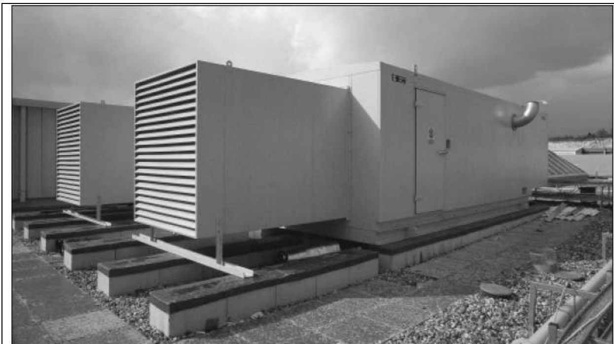
Два маломощных дежурных агрегата по 1000 кВА с «навесными» корпусами на крыше здания устраняют множество проблем, но создают другие
