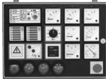
Рис. 1. Система управления питанием PLC с демонстрацией всех возможностей, включая два сигнальных устройства
