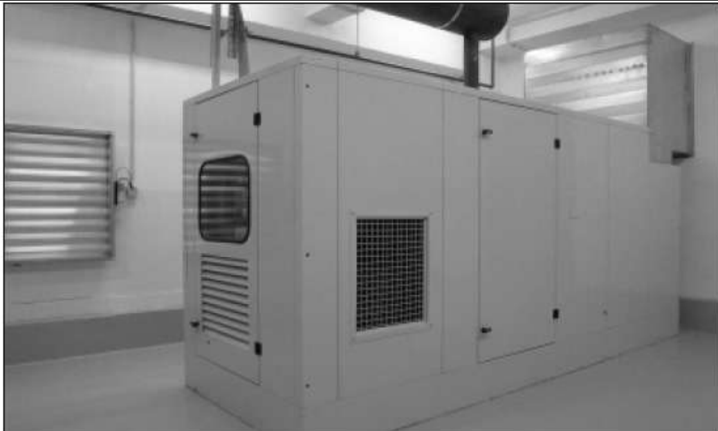
Сверхмалозумный генераторный агрегат Cummins на 110 кВА, установленный в акустически обработанном машинном зале. Метод позволяет достичь сверхнизких уровней звука в местах, чувствительных к шуму, таких как этот отель «Хилтон».
