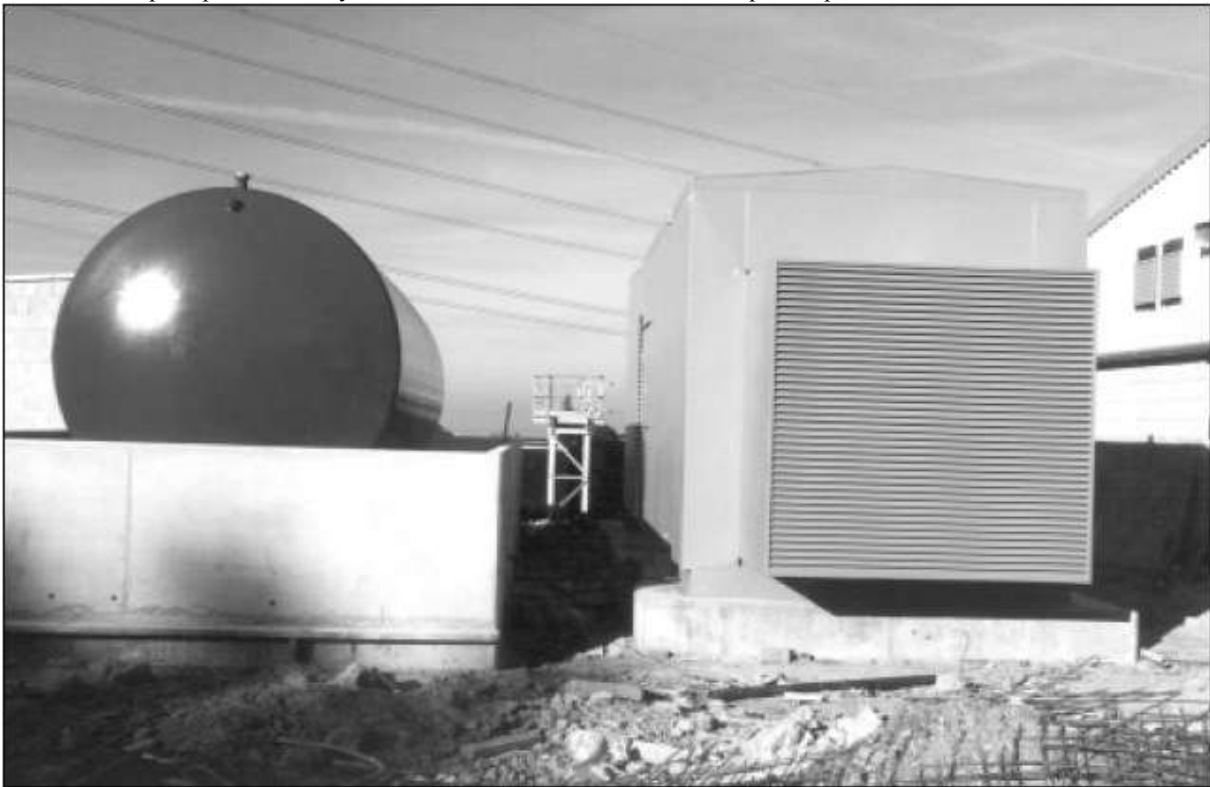
Наливная цистерна емкостью 14000 литров (3000 галлонов) в поддоне, обеспечивает топливом супершумоизолированный агрегат мощностью 500 кВА в объеме, достаточном для работы с полной нагрузкой в течение 6 дней.
