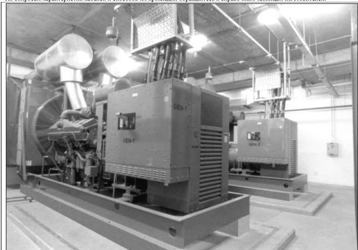
Верхняя подводка кабеля и потолочный кабелепровод между агрегатами (1000 кВА каждый).
