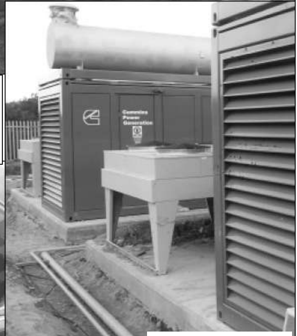
Топливопроводы и дополнительная кабельная разводка
