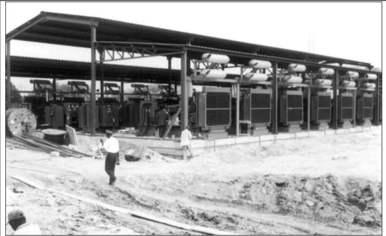
Множественные высоковольтные генераторы, работающие независимо от внешнего источника питания
