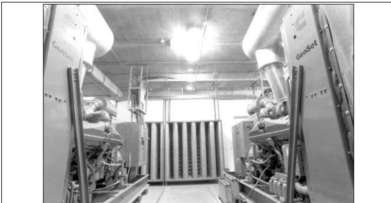
Аттенюаторы звука внутри машинного зала на два агрегата CP1250-5 по 1256 кВА каждый.
