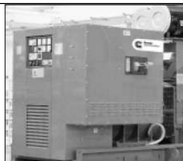
Типовая установка на агрегате прерывателя до 1000 А
