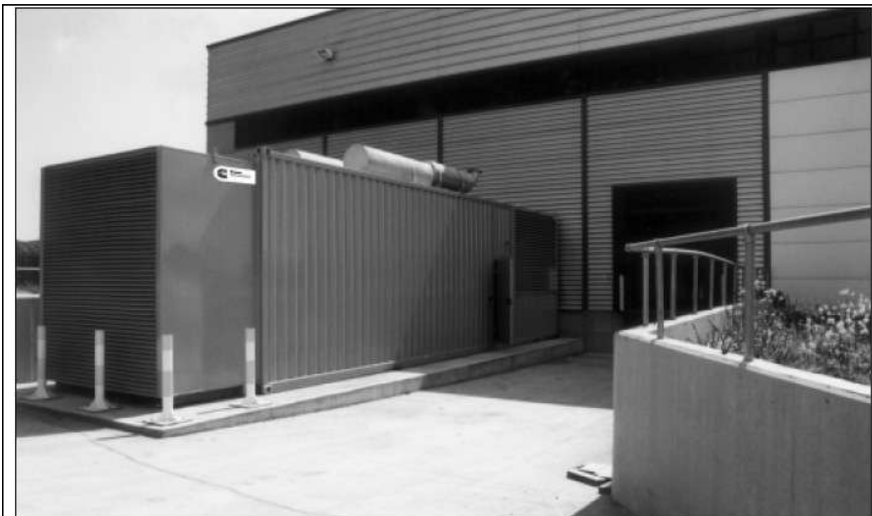
Малозумный контейнерный корпус длиной 12 м (40 футов) с генератором на 2000 кВА. Низкий уровень шума допускает установку поблизости от здания, уменьшая длину кабеля.
