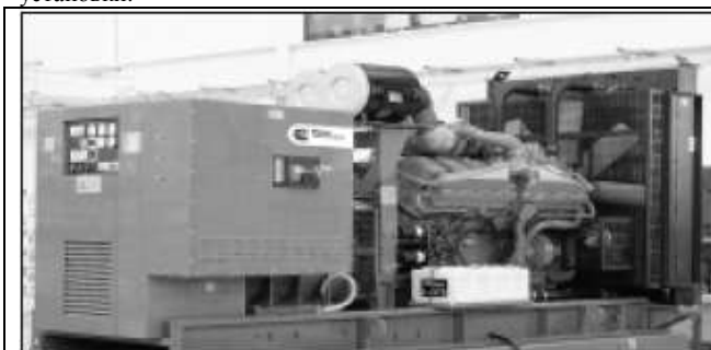
Типовая установка на агрегате прерывателя до 700 А
