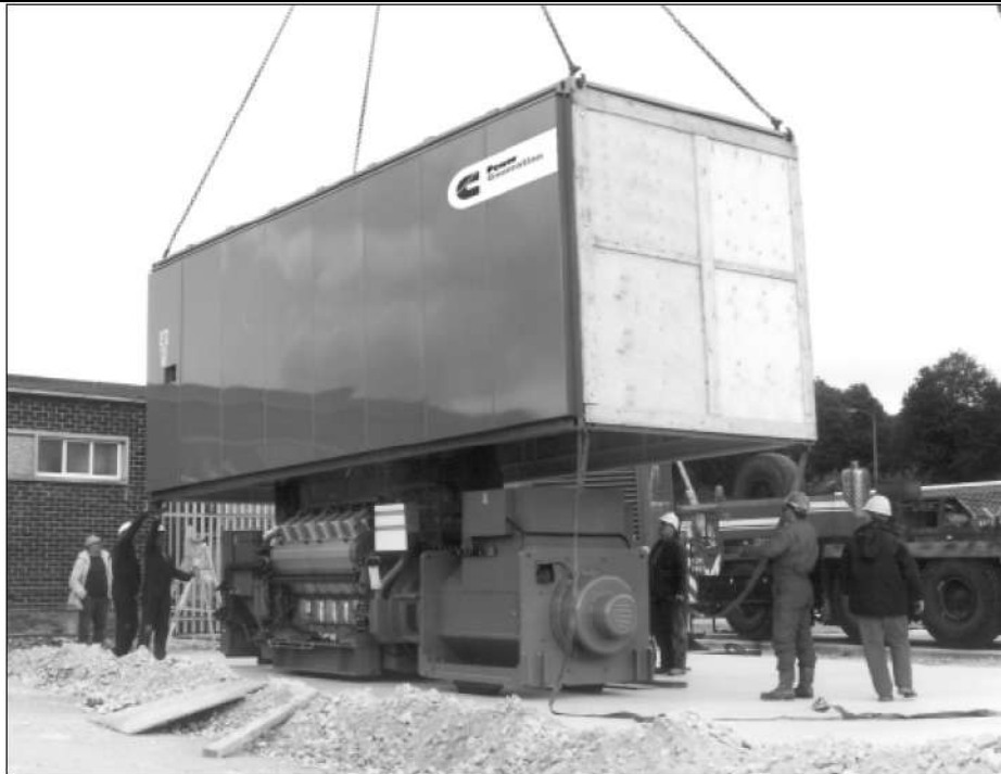
«Надеваемый» сверхмощный корпус для генератора первичного питания мощностью 3700 кВА устанавливается на специально подготовленное цементное основание.
