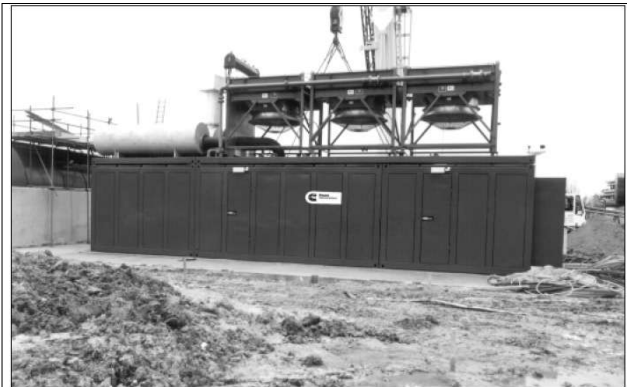
Полная установка газового генераторного агрегата на 1750 кВт агрегата с радиаторами выхлопной системой на крыше.
