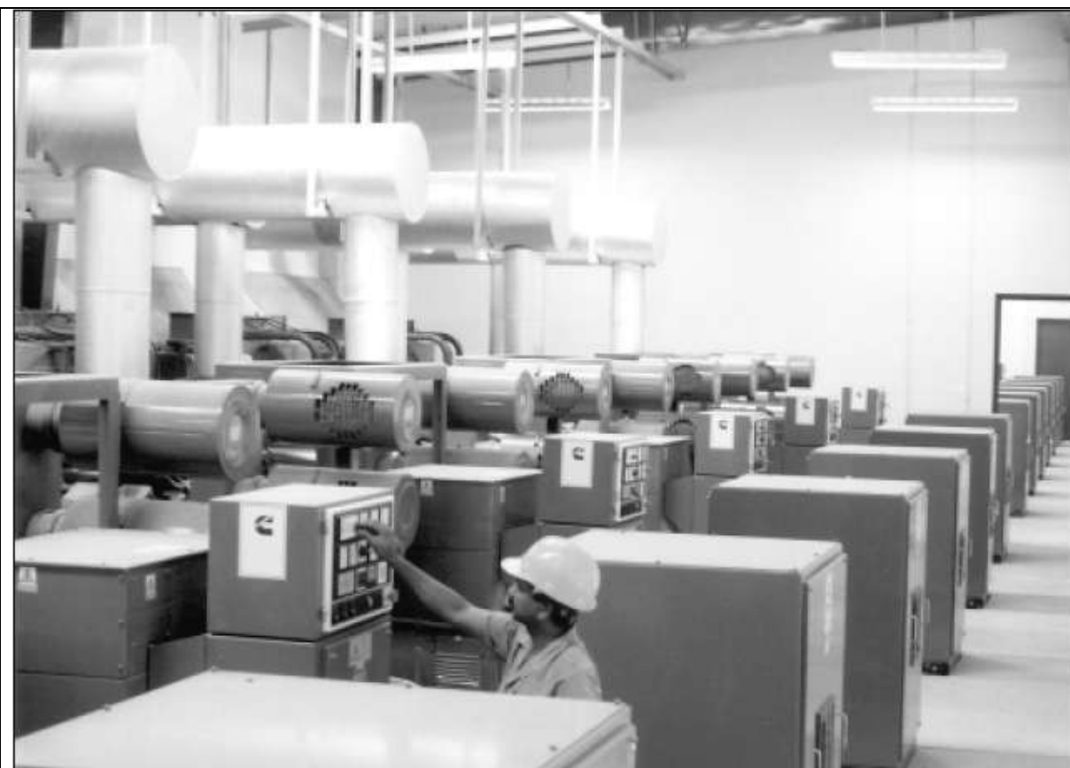
Двенадцать агрегатов по 1250 кВА работают вместе в качестве источника основного питания строительного лагеря с использованием системы управления PCL
