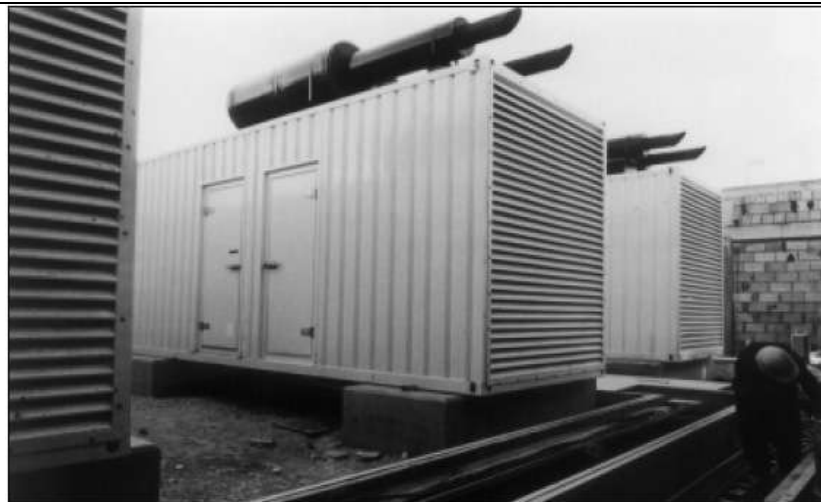
Три маломощных генератора Cummins по 1000 кВт каждый. Методика использования цементного основания устраняет необходимость укладки большой цементной плиты на всей площади установки, что позволяет экономить средства. Метод также может использоваться для установки агрегатов на крыше где иногда необходимо точечное приложение нагрузки.
