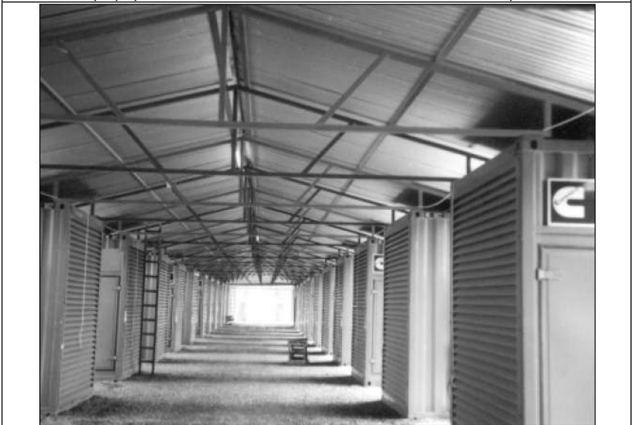
Станция из нескольких низковольтных генераторов
